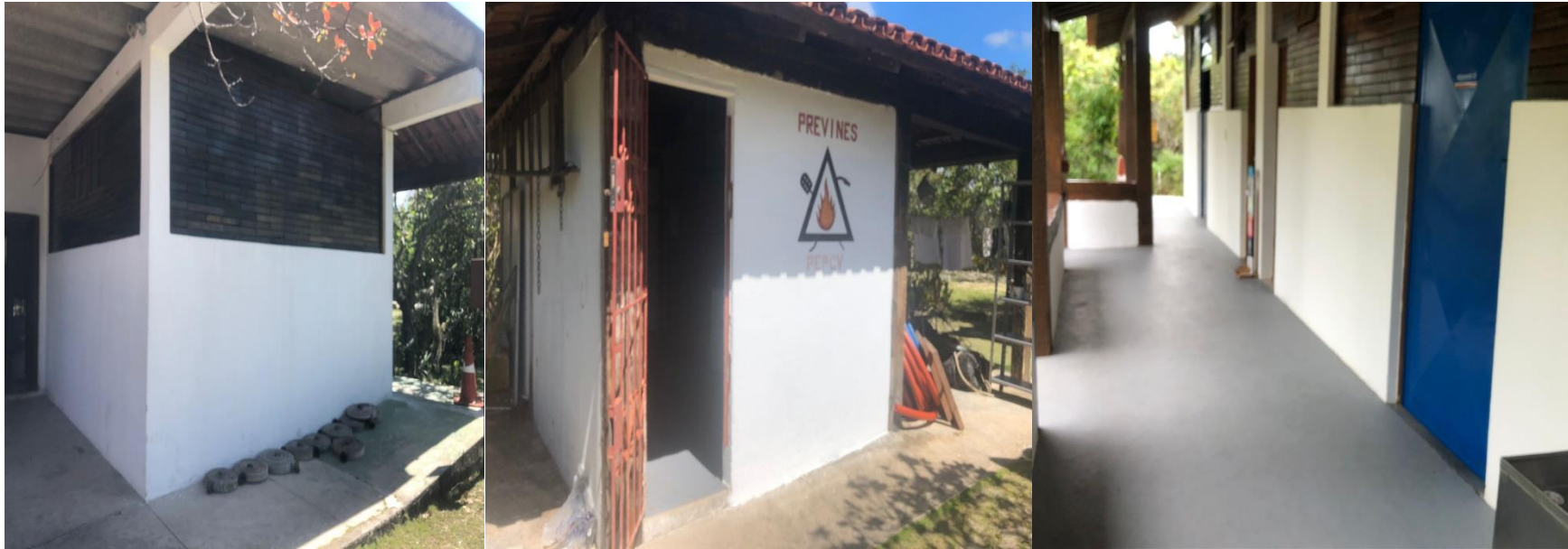
Figura 8 - Manutenção Elétrica e Predial PEPCV
