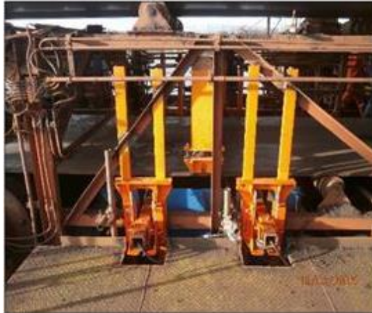
Raspadores pneumáticos secundários na traseira dos CNs.
