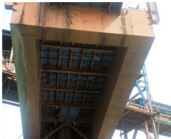
Substituição de chapas expandidas por chapas corrugadas (azul) em diversos pontos dos CNs. A última foto mostra as substituições vista por baixo do CN3.
