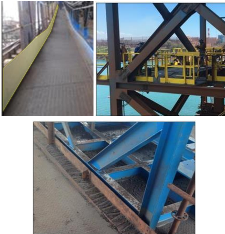
Rodapés de 200 mm (primeira imagem, destaque em amarelo) no piso dos transportadores, plataforma com guarda-corpo e fechamento do piso na região da talha de D15.
