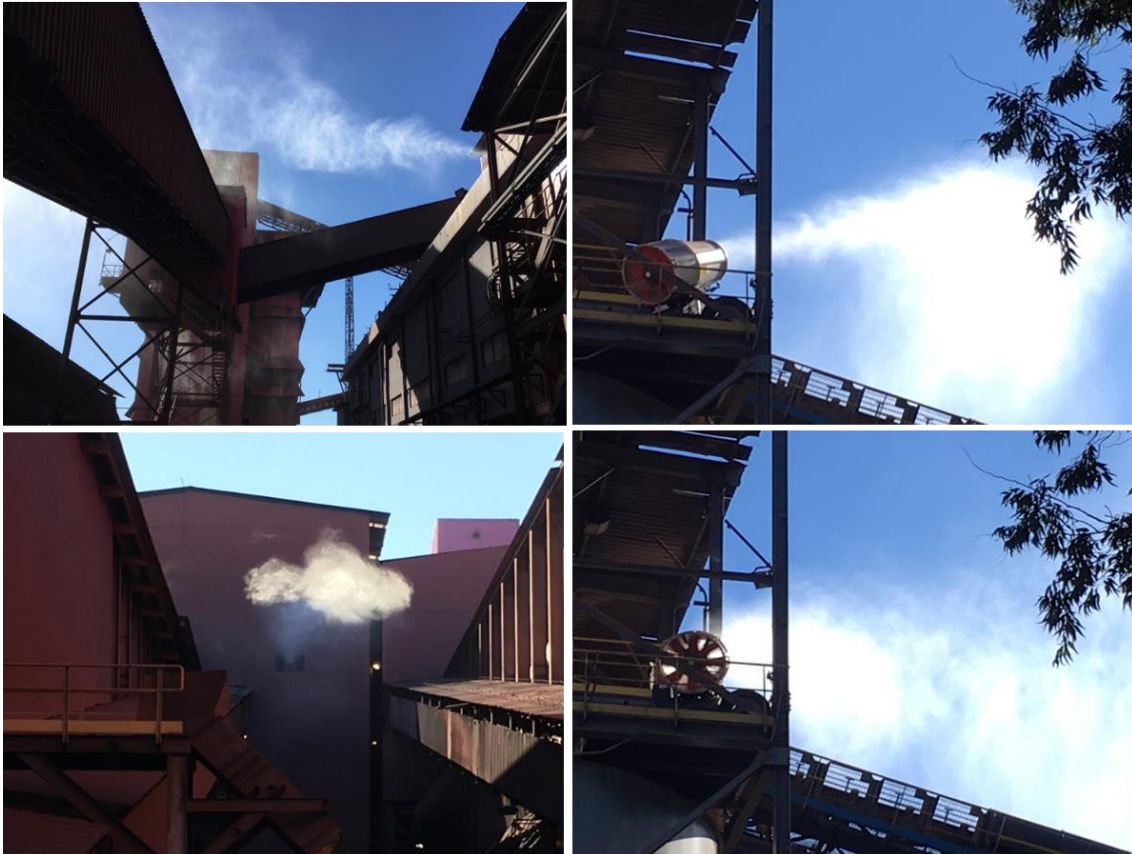
Canhões de névoa instalados nas usinas 3 e 4).
