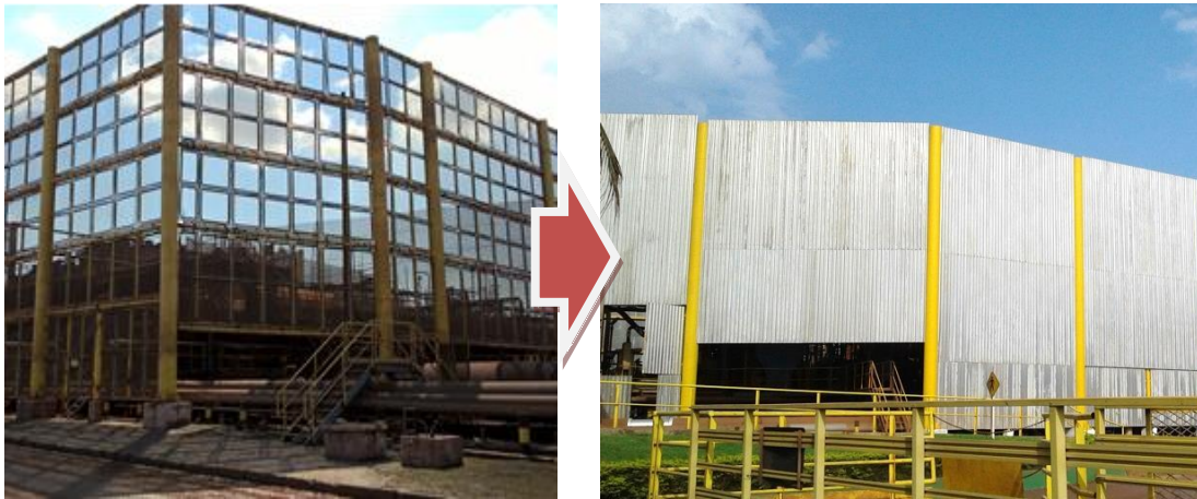
Enclausuramento com material rígido da casa de transferência dos transportadores “D”.
