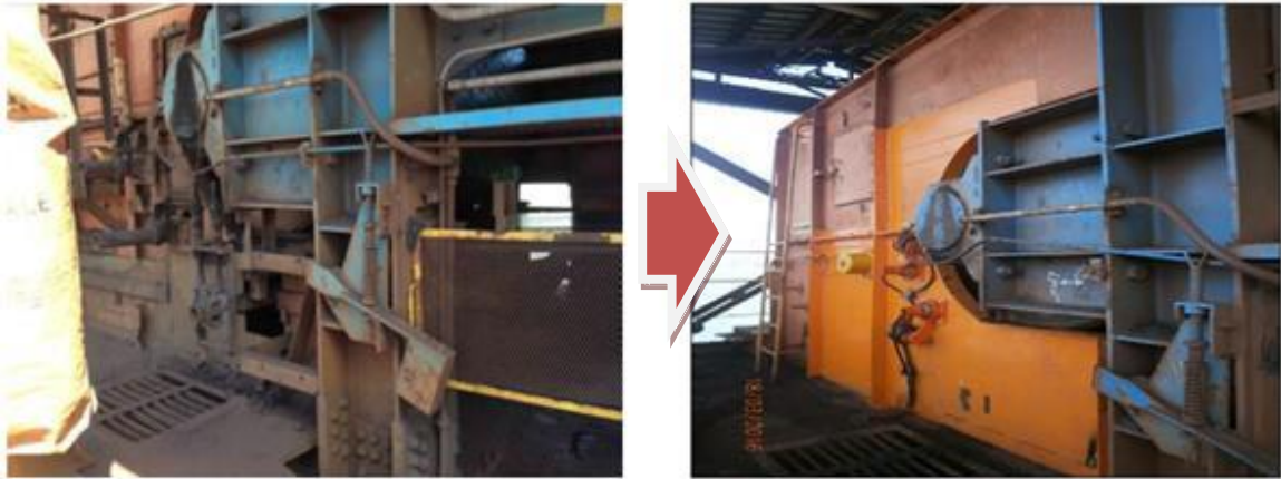
Fechamento de aberturas (laranja), substituição e instalação de raspadores pneumáticos no transportador D13.
