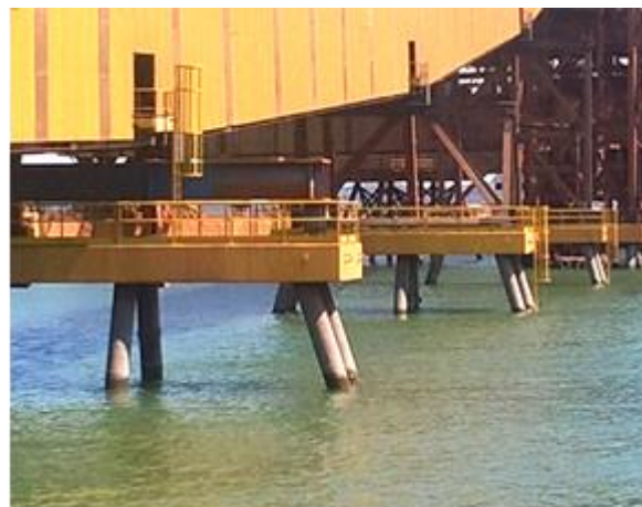
Dolphins de atracação com rodapé aumentado (destaque em amarelo) e bases dos transportadores com contenções e guarda-corpo.
