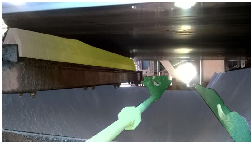
Sistema de limpeza de correia com aspersores (verde) e raspadores (amarelo). O material é recolhido por calha (azul).
