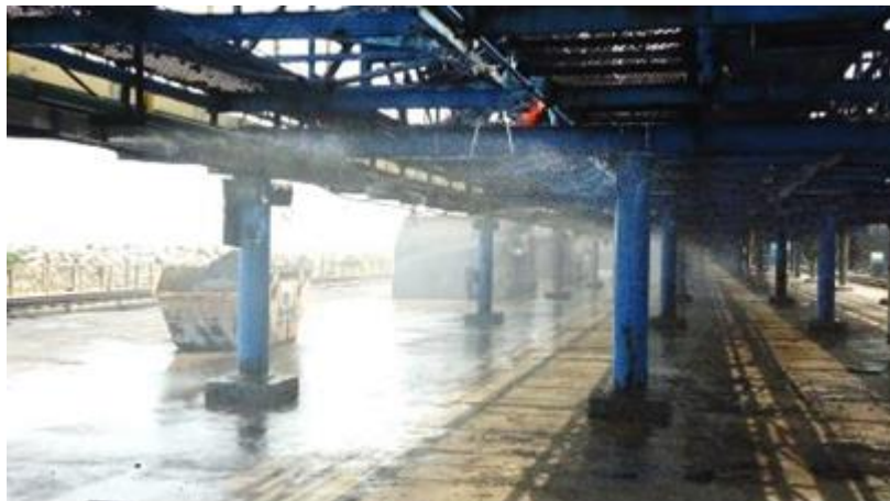
Aspersão sob os transportadores do Píer de Carvão.
