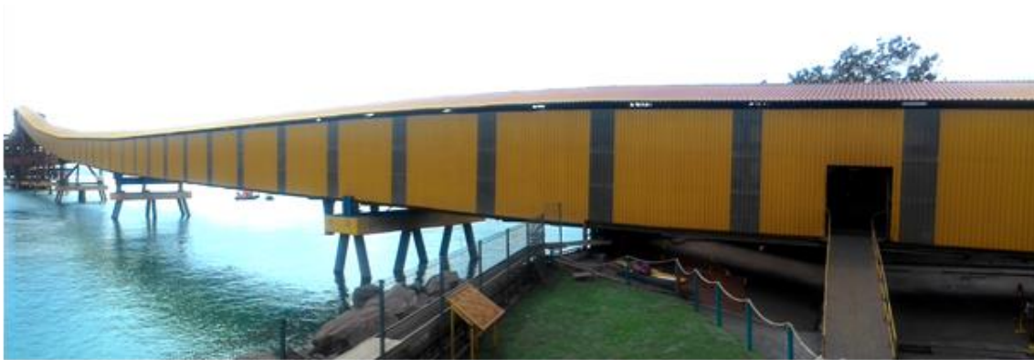
Enclausuramento do transportador do pier 2 visto da área administrativa. Antes e Depois.
