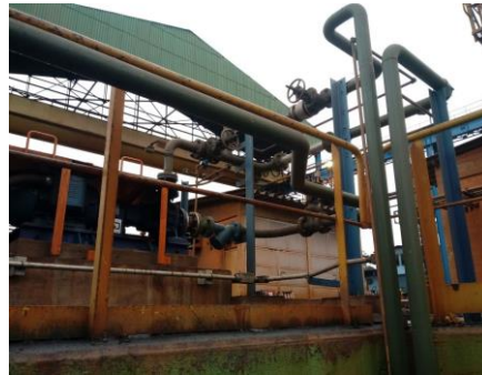
Novo sistema de bombas e tubulação
