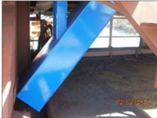
Calha de direcionamento de material de limpeza.
