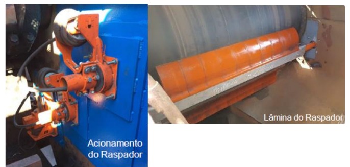
Sistema de raspador pneumático no Carregador de navio do píer I.
