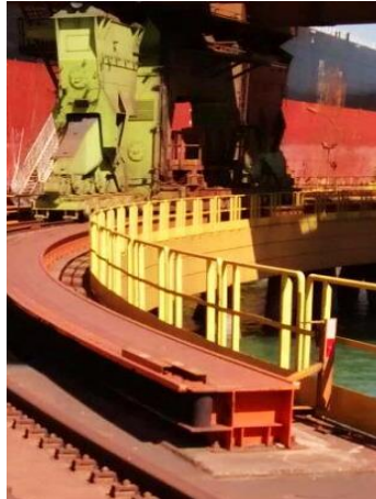
Guarda-corpo para viabilização de limpeza na porção traseira do trilho.
