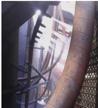
Bicos aspersores inferiores dos Viradores de Vagões.
