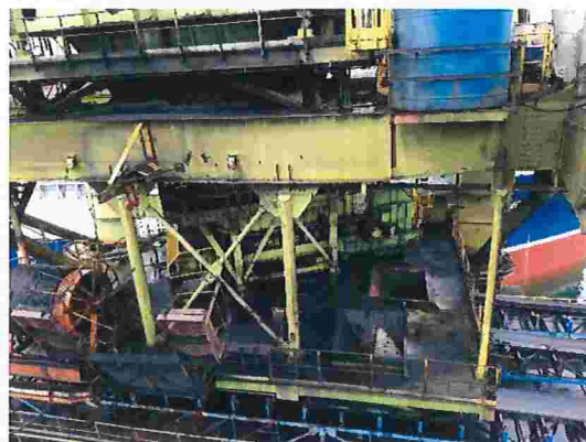
Figura 73 – Material depositado na estrutura do descarregador de navios
