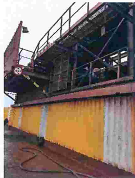
Figura 48 – Reversor de correia transportadora de minério do Píer 1 sem contenção lateral
