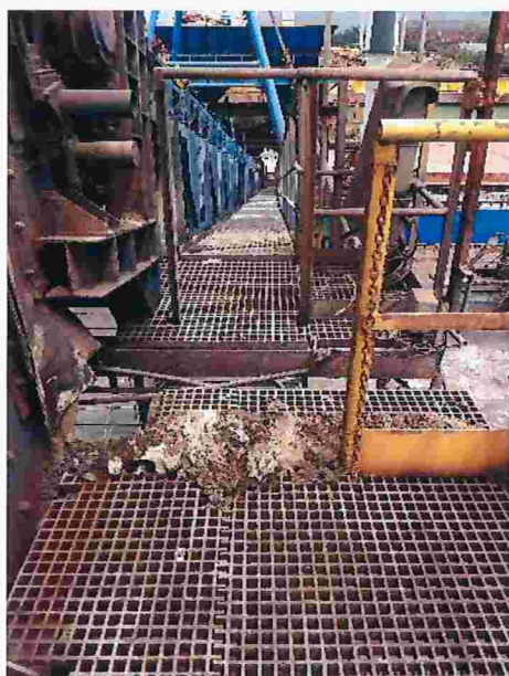
Figura 58 – Depósito de material na correia do descarregador de navio
