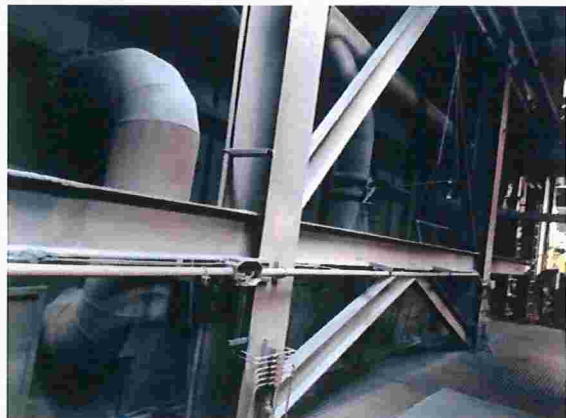
Figura 14 – Visão lateral do forno
