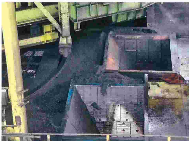
Figura 74 – Acúmulo de materiais no descarregador de navios
