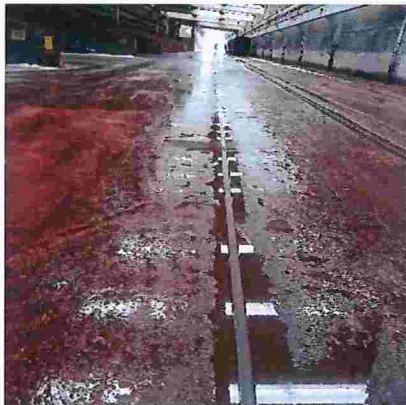
Figura 62 – Interior do armazém de fertilizantes sem drenagem
