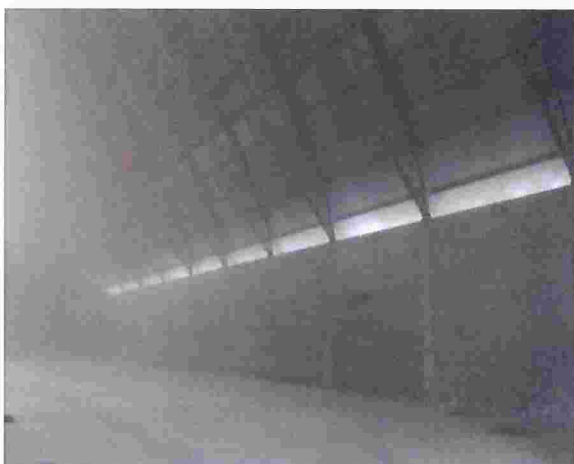
Figura 78 – Interior do armazém de grãos (soja) com fendas laterais
