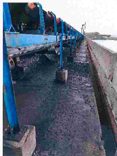
Figura 75 – Correia transportadora de carvão para Arcelor sem enclausuramento
