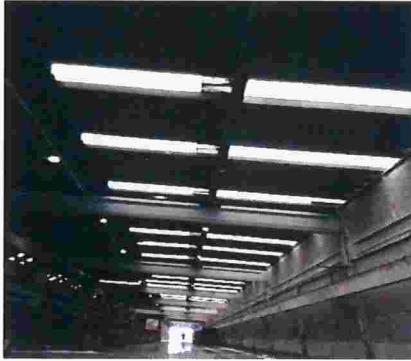
Figura 60 – Cobertura do armazém de fertilizantes com frestas e furos
