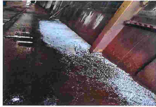
Figura 61 – Interior do armazém de fertilizantes após chuva
