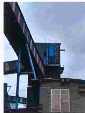
Figura 69 – Filtro de mangas nos chutes das correias transportadoras de grãos
