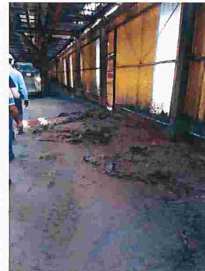
Figura 47 – Interior da contenção inferior da correia transportadora de minério do Píer 1
