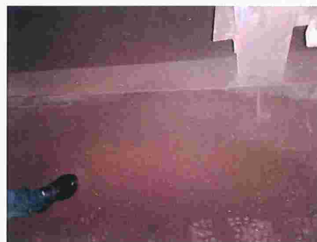
Figura 45 – Detalhe de acúmulo de pó no interior da unidade
