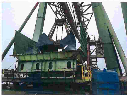
Figura 72 – Depósito de produtos descarregados nas estruturas, durante a operação da mandíbula (grab) com umectação
