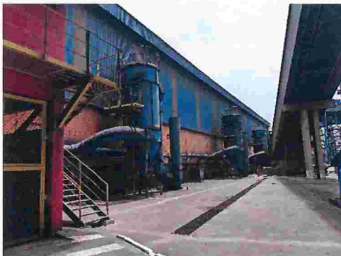
Figura 68 – Filtros de mangas das moegas de grãos e correia transportadora sem bandejamento
