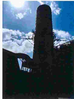
Figura 128 – Detalhe da chaminé de lançamento dos gases
