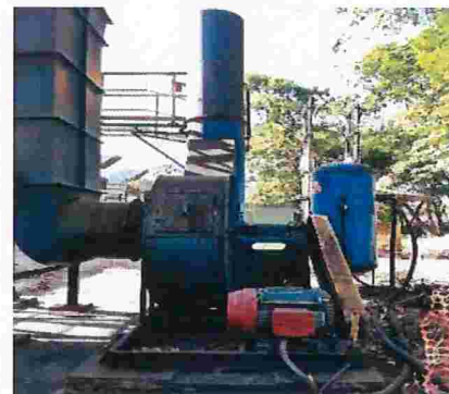
Figura 198 – Ventilador e chaminé para lançamento de gases com deterioração
