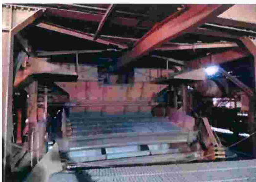
Figura 109 – Captação da entrada das pelotas no forno
