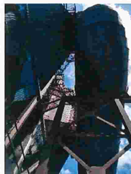
Figura 134 – Detalhe dos dutos de saída de gases dos precipitadores eletrostáticos
