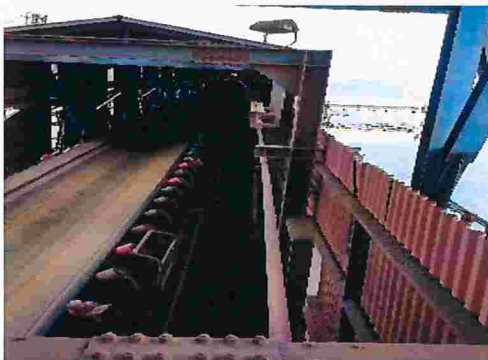
Figura 65 – Partes abertas na parte superior ao longo da correia transportadora sem contenção de material
