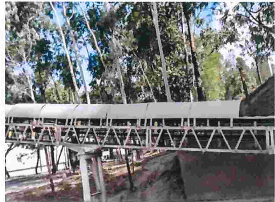
Figura 142 – Acúmulo de material na parte inferior da correia transportadora provida de cobertura, sem contensão lateral e bandejamento
