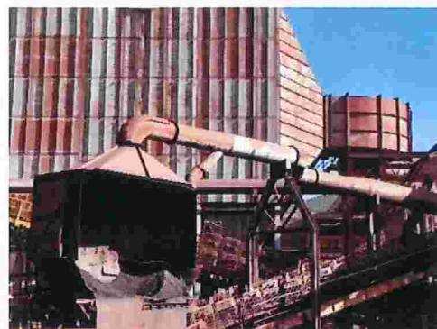
Figura 140 – Moega com alimentação por pá carregadeira para peneira de emergência
