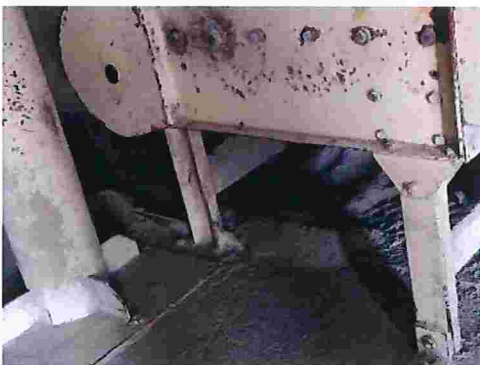
Figura 161 – Detalhe de acúmulo de particulado no piso
