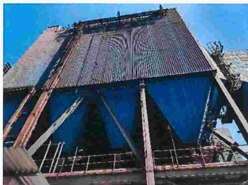
Figura 133 – Detalhe do precipitador eletrostático
