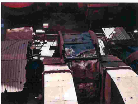
Figura 115 – Detalhe de um dos ventiladores com proteção em mau estado
