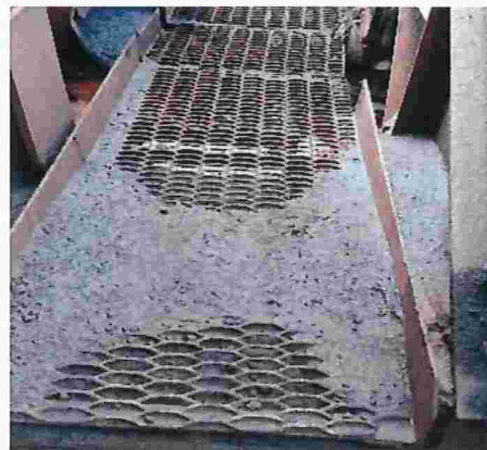
Figura 52 – Depósito de material ao lado da correia transportadora
