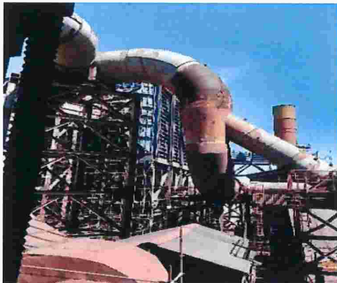
Figura 187 – Dutos do sistema de captação de gases
