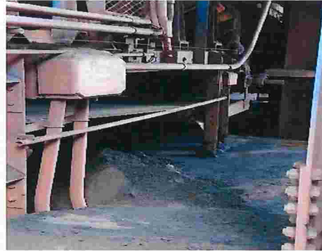
Figura 62 – Detalhe de material depositado embaixo da correia transportadora
