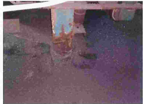
Figura 176 – Acúmulo de material no piso
