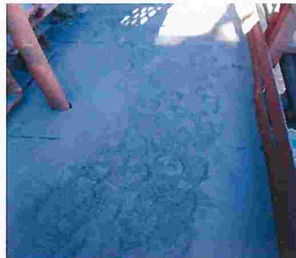
Figura 108 – Depósito de material nas estruturas
