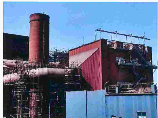
Figura 188 – Precipitador eletrostático com chaminé sem identificação
