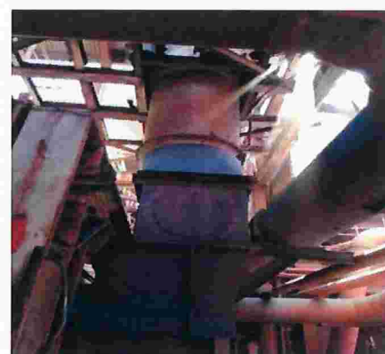
Figura 116 – Captação do resfriador do forno
