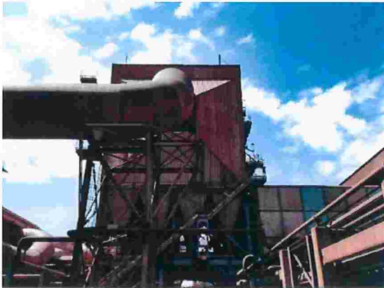
Figura 127 – Detalhe da entrada dos gases no precipitador eletrostático
