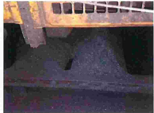
Figura 174 – Acúmulo de material no piso embaixo de correia transportadora
