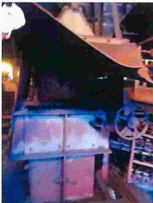
Figura 125 – Captação da peneira com anteparo de borracha
