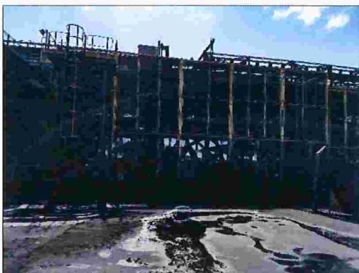
Figura 3 – Chutes providos de telas com projeção de material
