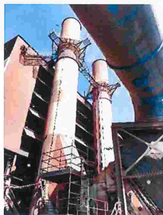
Figura 135 – Detalhe da chaminé de lançamento dos gases
