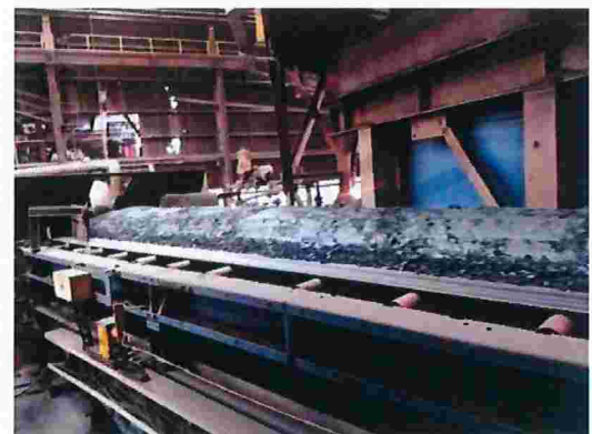
Figura 172 – Detalhe de correia transportadora sem contenção lateral
