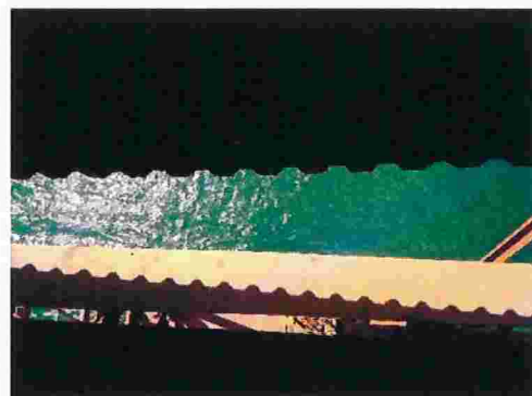
Figura 60 – Detalhe de frestas na parede lateral do enclausuramento da correia
