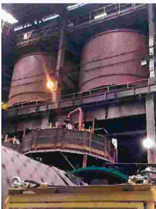
Figura 171 – Detalhe dos hidrociclones
