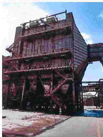
Figura 129 – Detalhe do precipitador eletrostático
