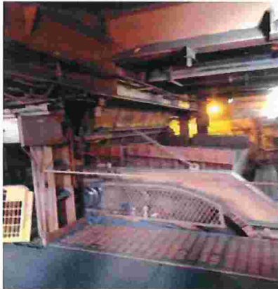
Figura 123 – Entrada do forno de grelha
