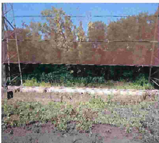
Figura 103 – Fendas na wind fence localizada ao redor do pátio
