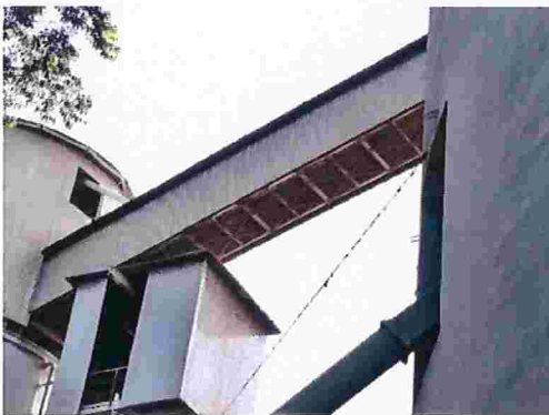
Figura 143 – Correia transportadora provida de cobertura e contensão lateral e sem bandejamento (provida de grade)
