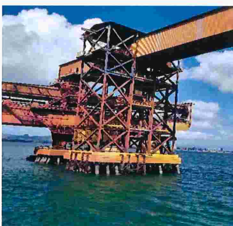
Figura 47 – Chute do carregador de navios (CN-4)
