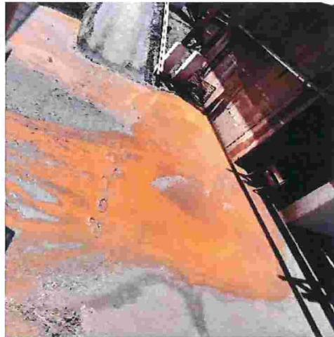
Figura 68 – Material depositado no piso da estrutura da entrada da correia
