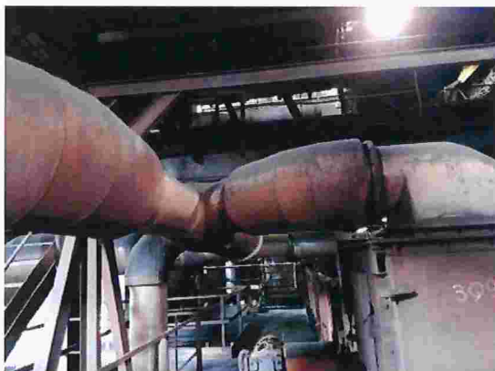
Figura 113 – Dutos de captação com pó depositado na parte superior
