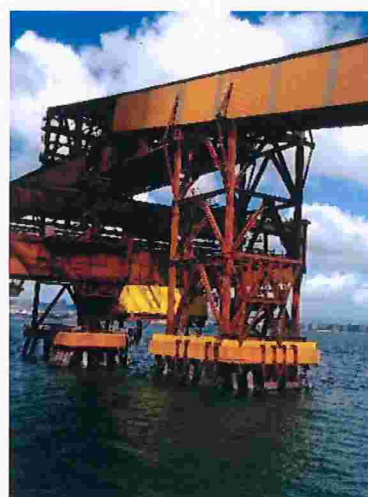
Figura 46 – Chute do carregador de navios (CN-3)
