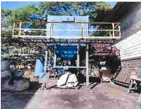
Figura 197 – Detalhe do filtro de mangas
