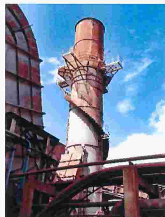
Figura 130 – Detalhe da chaminé de lançamento dos gases
