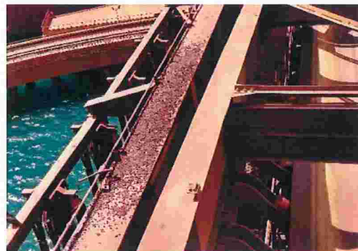
Figura 56 – Detalhe de pelotas depositadas nas estruturas
