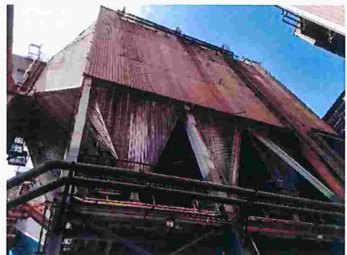
Figura 132 – Detalhe do precipitador eletrostático
