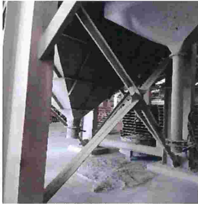
Figura 163 – Acúmulo de material no piso do galpão de ensaue
