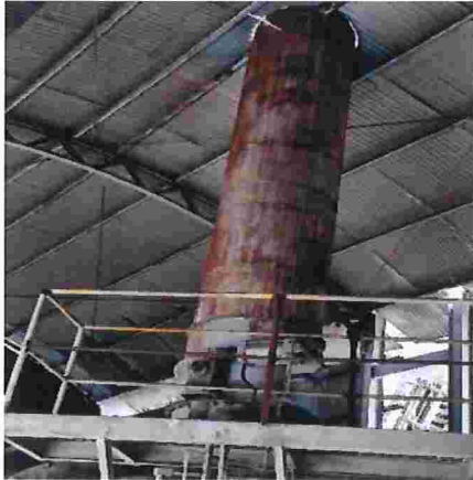
Figura 157 – Dutos de gases quentes com deterioração
