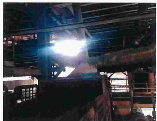
Figura 114 – Captação da correia transportadora com pó depositado no duto
