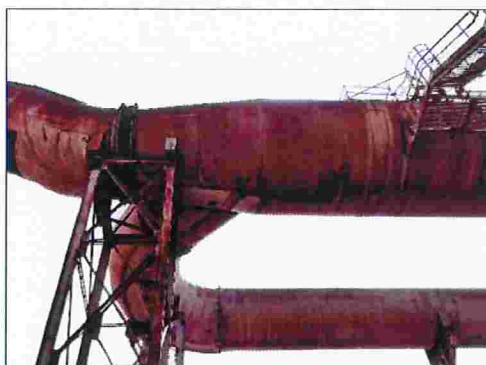
Figura 131 – Detalhe dos dutos do sistema de captação de gases
