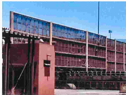
Figura 22 – Telas da torre de transferência em mau estado e com acúmulo de pó
