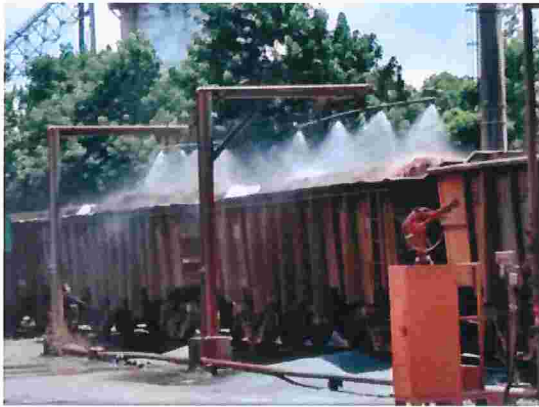
Figura 77 – Aspersão do vagão de minério previamente ao virador de vagões
