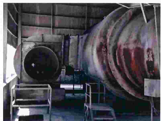
Figura 156 – Sistema de aquecimento de gases com deterioração
