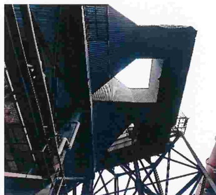
Figura 118 – Dutos de saída do precipitador eletrostático
