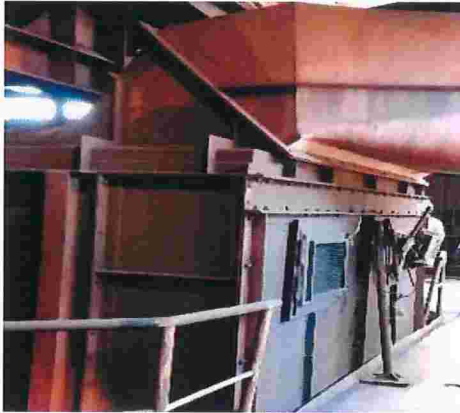
Figura 185 – Detalhe do resfriador com ponto de captação
