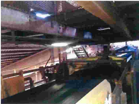
Figura 175 – Sistema de by-pass e ponto de captação de correia transportadora
