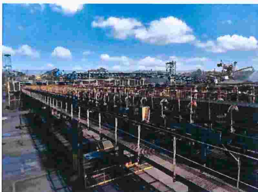
Figura 5 – Correias sem cobertura superior, bandejamento e contenção lateral
