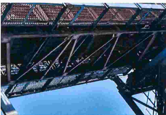
Figura 91 – Detalhe das grades das correias transportadoras (Pátio M)
