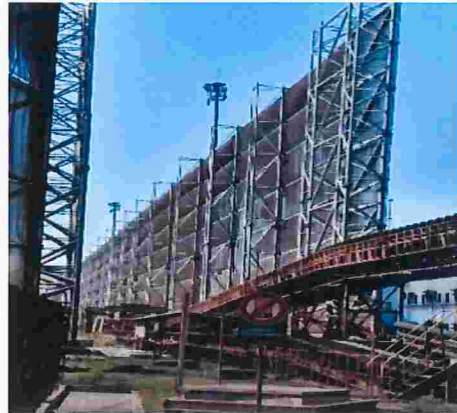
Figura 30 – Fendas na estrutura da wind fence
