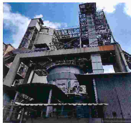
Figura 154 – Sistema de resfriamento/aquecimento dos gases
