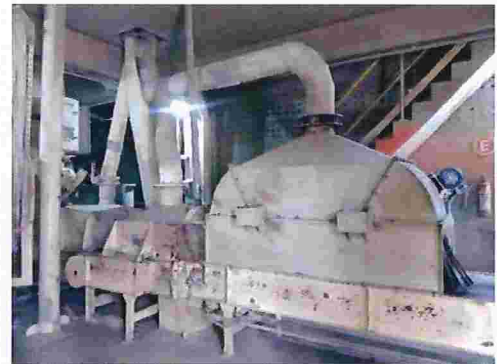
Figura 160 – Sistema de captação do ensaque com deterioração
