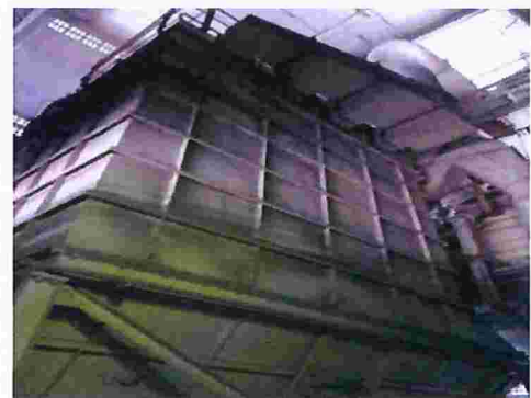
Figura 162 – Detalhe do filtro de mangas da área de ensaque
