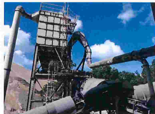
Figura 150 – Silos dosadores providos de filtros de mangas
