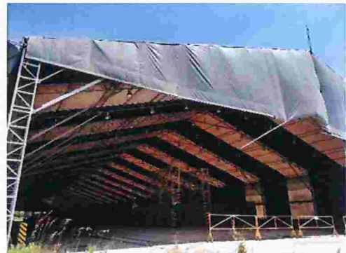
Figura 166 – Galpão com calcário armazenado em baias e piso com impermeabilização sem anteparos na saída
