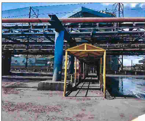
Figura 7 – Passagem sob as correias para evitar contato pela queda do material transportado
