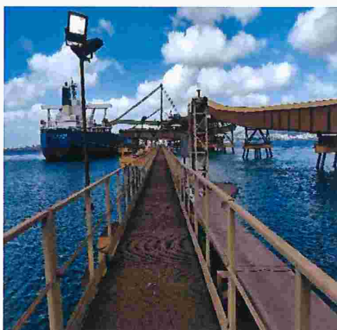
Figura 45 – Correia transportadora de materiais enclausurada do carregador de navio
