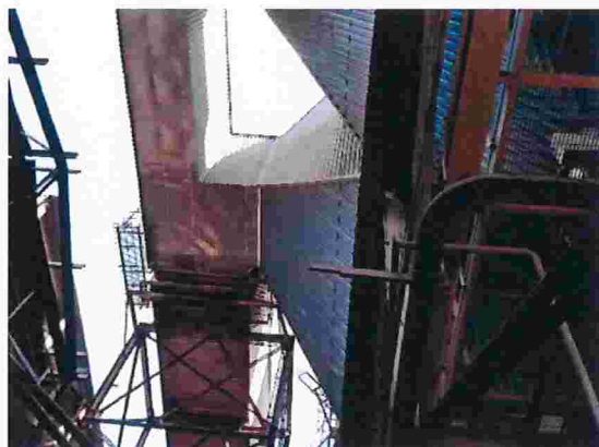
Figura 117 – Dutos de entrada do precipitador eletrostático (Os colaboradores da Vale não sabem a qual unidade eles pertencem, assim deixaremos sem identificação)
