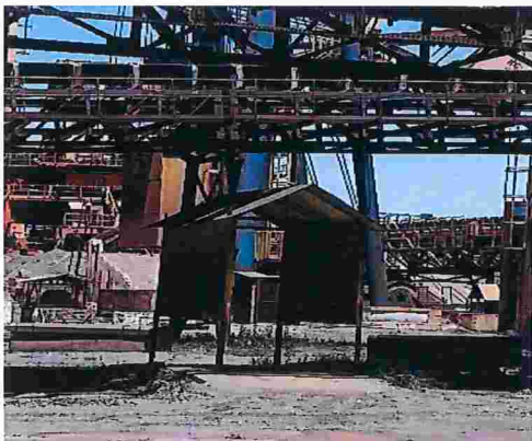
Figura 23 – Passagem sob as correias transportadoras sem bandejamento ou contenção
