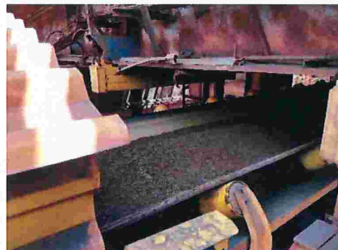
Figura 66 – Partes abertas na estrutura da correia
