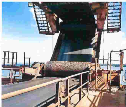
Figura 55 – Reversor de correia da lança sem aspersão de água na correia
