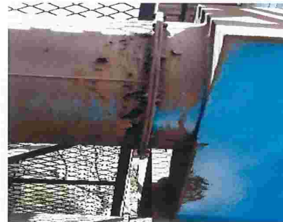
Figura 196 – Duto de interligação do sistema de captação com equipamento de controle corroído
