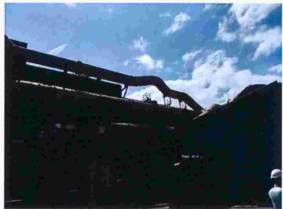
Figura 126 – Detalhe dos dutos do sistema de captação
