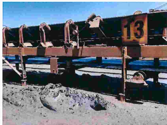
Figura 24 – Correias transportadoras do pátio sem cobertura, contenção lateral ou inferior e acúmulo de material no solo
