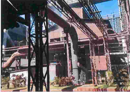
Figura 97 – Aspersão de água por canhão (fog) nas usinas 3 e 4
