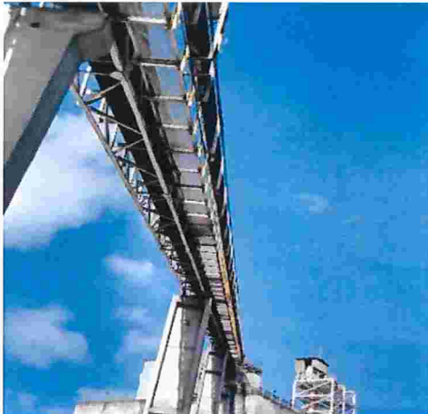
Figura 141 – Detalhe de correia transportadora sem cobertura, contensão lateral e bandejamento
