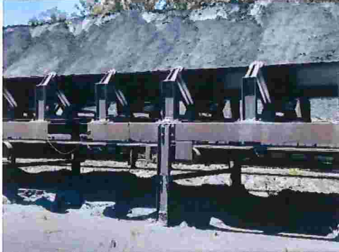
Figura 81 – Correias transportadoras sem cobertura e sem contenções laterais (Pátio L)
