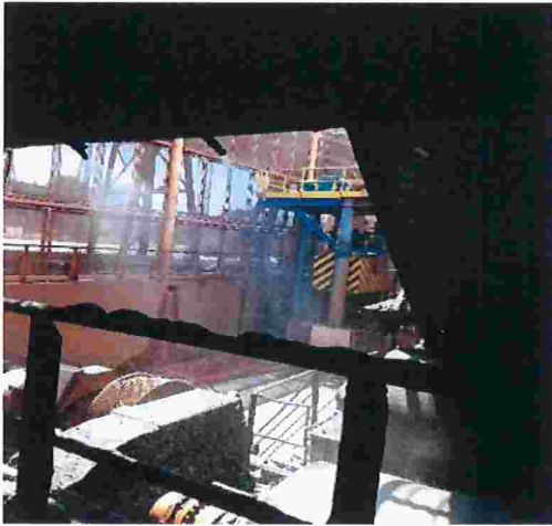
Figura 67 – Aspersão de água na inversão da correia (entrada)
