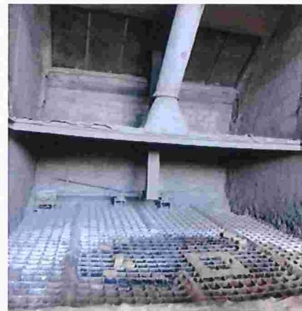
Figura 148 – Moega com vazador para descarga de materiais com captação
