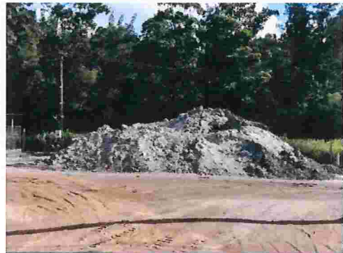
Figura 146 – Pilhas de materiais a céu aberto sem identificação
