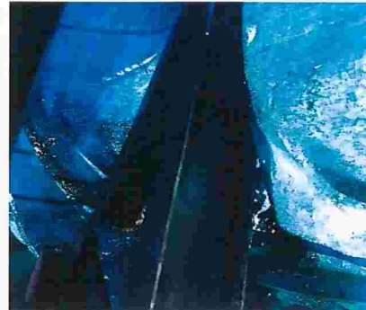
Figura 190 – Detalhe da lona com furos causados pelo jateamento com sinter ball
