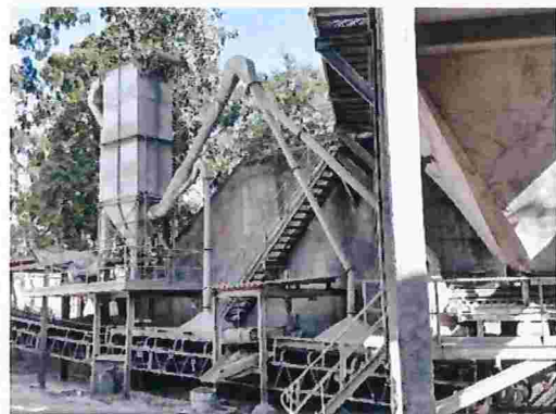
Figura 144 – Moega principal provida de sistema de captação e filtro de mangas com material depositado na estrutura e no solo
