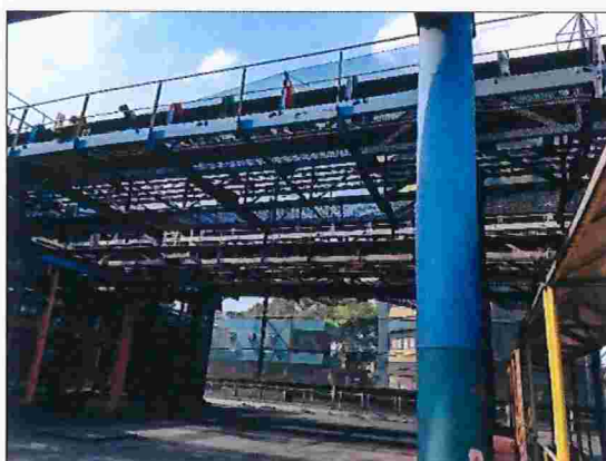
Figura 8 – detalhe das correias transportadoras sem bandejamento, cobertura e contenção lateral
