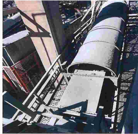
Figura 101 – Correia transportadora do pátio de materiais com acúmulo de pó
