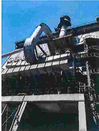
Figura 144 – Duto de lançamento dos gases para atmosfera
