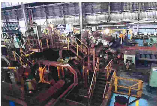
Figura 69 – Detalhe da entrada nas bobinadeiras
