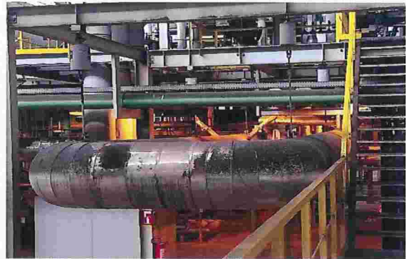
Figura 54 – Detalhe da tubulação de gases de entrada com poeira depositada
