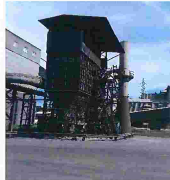
Figura 44 – Filtro de mangas para controle das emissões dos silos térreos
