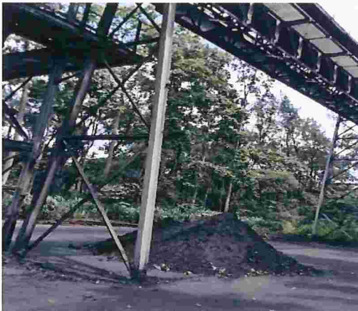
Figura 21 – Detalhe de acúmulo de material embaixo da correia transportadora de carvão para a Heat recovery
