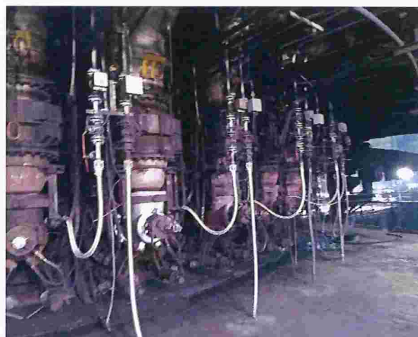
Figura 115 – Detalhe das ventaneiras do Alto forno 1
