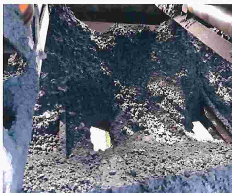
Figura 6 – Detalhe de acúmulo de material na parte inferior com buracos na estrutura
