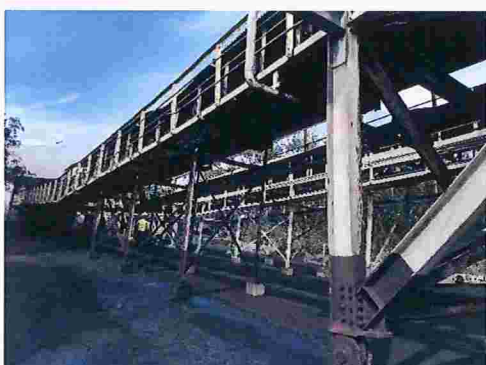
Figura 3 – Correia transportadora de carvão sem contenção lateral e sem bandejamento (grelha)
