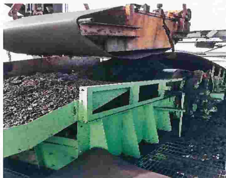
Figura 8 – Acúmulo de carvão na estrutura na descarga de material para o chute
