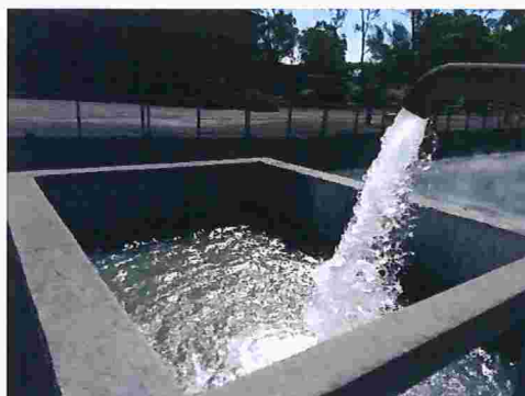
Figura 153 – Tanque de água de reuso
