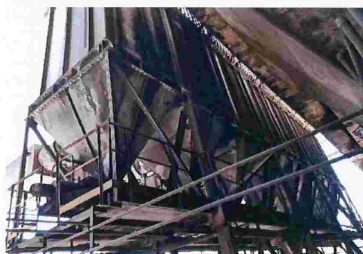
Figura 142 – Filtro de mangas dos silos de minério
