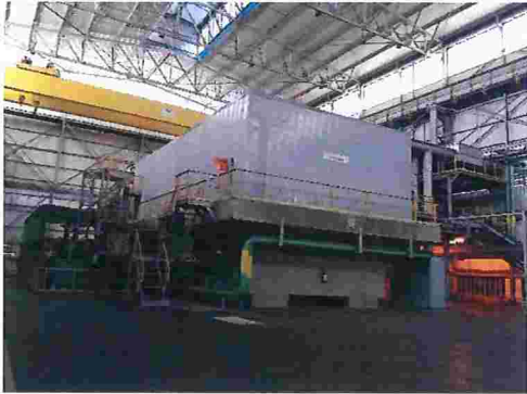
Figura 53 – Detalhe do turbo gerador da CTE 5 e 6 da Coqueria Sol
