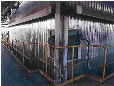
Figura 49 – Detalhe da caldeira de geração de vapor da CTE
