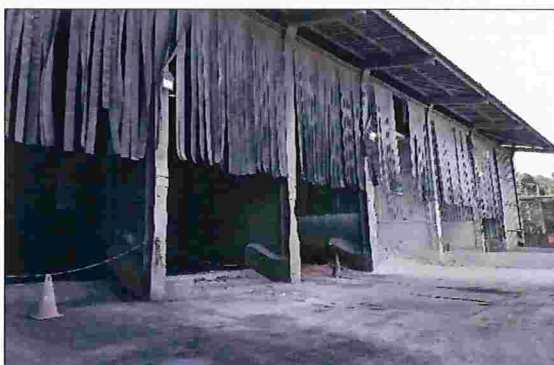
Figura 41 – Silos térreos para armazenamento de fundentes e ligas
