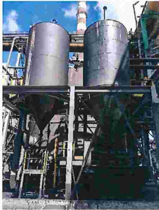
Figura 73 – Detalhe do processo de decantação
