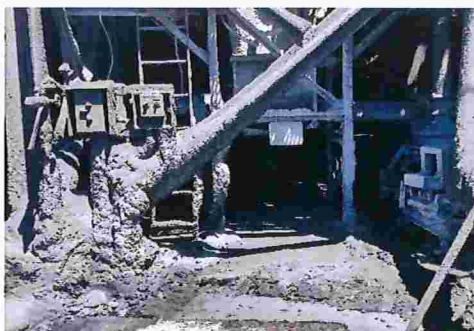
Figura 161 – Pó depositado nas estruturas
