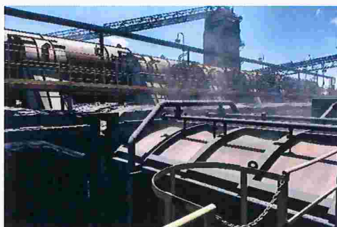
Figura 88 – Detalhe do acoplamento hot car no forno da bateria para carregamento do coque com emissão fugitiva
