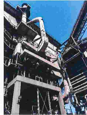
Figura 145 – Duto de lançamento dos gases para atmosfera
