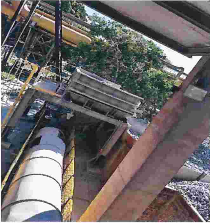
Figura 100 – O material é carregado em moega e segue por correia transportadora, observado acúmulo de pó nas estruturas.
