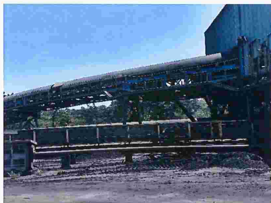
Figura 63 – Corriente de transporte de carvão com danos na cobertura e acúmulo de material no solo
