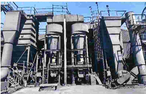
Figura 160 – Filtros de mangas e ciclones em estado precário de conservação
