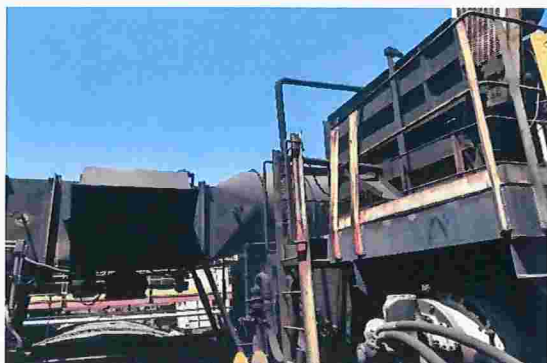
Figura 96 – Detalhe de entrada de ar para resfriamento de gases
