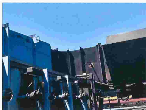
Figura 97 – Detalhe da entrada de ar frio nos filtros de mangas
