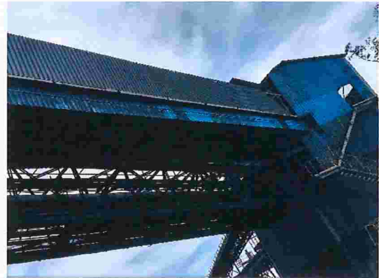
Figura 20 – Detalhe da correia transportadora de coque para o alto forno 3 com grade inferior danificada sobre via
