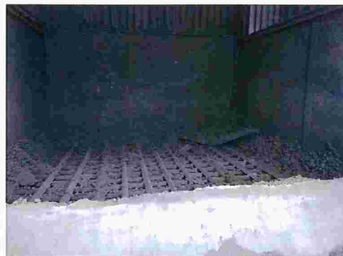
Figura 42 – Detalhe de material depositado no vazador de um silo térreo
