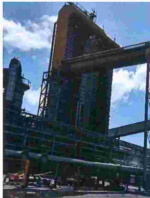
Figura 75 – Detalhe do precipitador e dos dutos com água para resfriamento (salgada).
