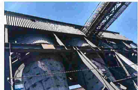
Figura 159 – Silos de armazenamento de materiais em estado precário de conservação
