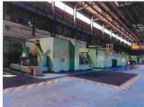
Figura 50 – Detalhe de um dos conjuntos TGS (turbina-gerador-soprador)
