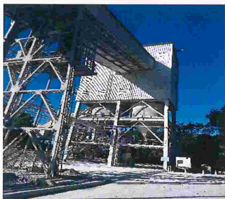
Figuras 112 – Silo de cal dolomítica e calcítica no limite de bateria entre a Arcelor e a Lhoist com acúmulo de pós no piso
