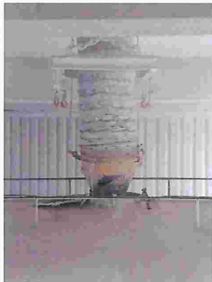
Figura 108 – Carregamento de caminhões com tromba telescópica porém sem sistema de captação
