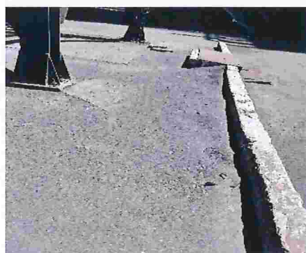
Figura 85 – Detalhe do piso ao redor do equipamento com acúmulo de pó
