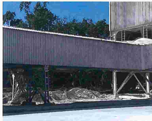
Figura 103 – Detalhe das correias transportadoras enclausuradas, mas com depósito de pós na cobertura e no piso.
