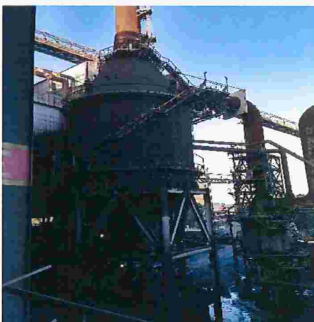
Figuras 118 – Ciclone que coleta o pó de balão gerado pelo sopro das ventaneiras
