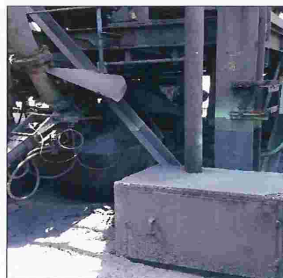
Figura 87 – acúmulo de material no interior da unidade
