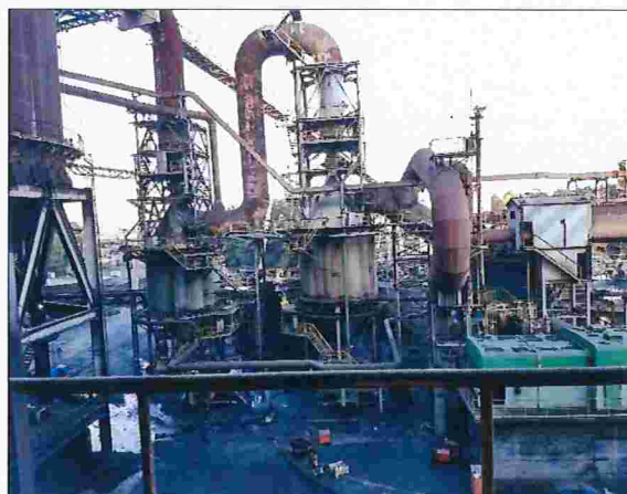
Figura 119 – Lavadores de gases para retenção do material particulado fino
