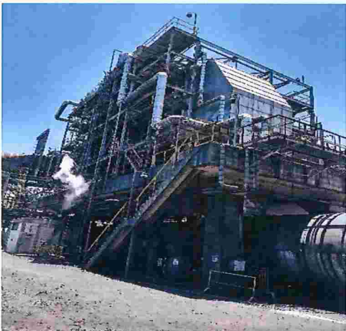
Figura 55 – Caldeira de recuperação que envia o vapor para CTE 5 e 6
