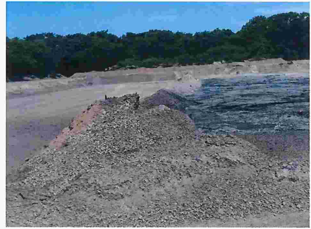
Figura 36 – Pátio de emergência BF3 para bascular torpedeo de gusa (baia recuperada e com escória)
