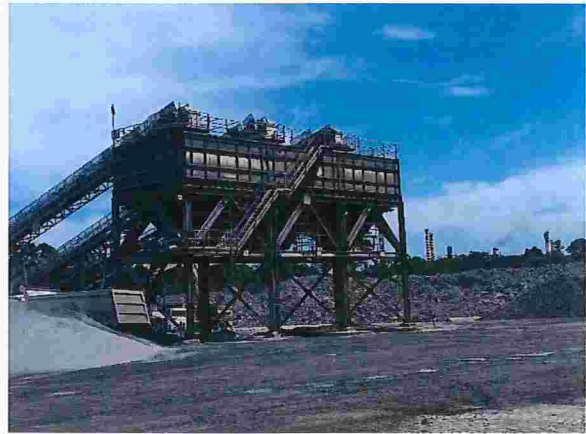
Figura 40 – Detalhe dos silos de recebimento de materiais
