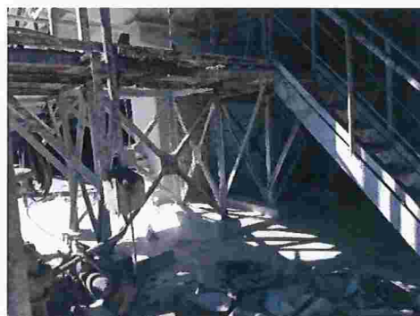
Figura 151 – Depósito de pó de cal no piso, nas estruturas e material depositado no solo
