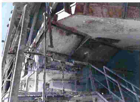
Figura 150 – Pó de cal depositado nas estruturas
