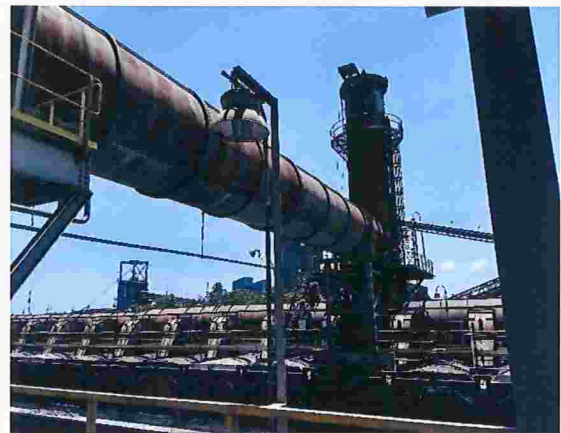
Figura 56 – Detalhe da válvula de alívio dos gases da caldeira, com lançamento sem tratamento.
