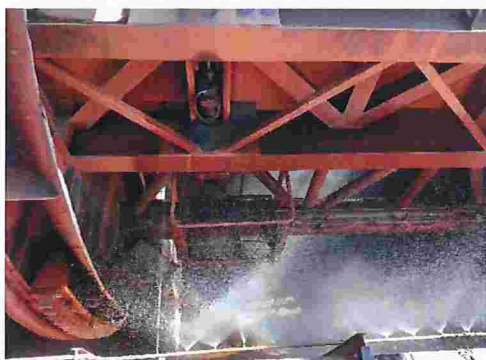
Figura 126 – Sistema de aspersão na lateral do virador de vagões
