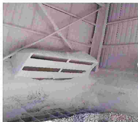
Figura 111 – Acúmulo de material no vazador e no captor
