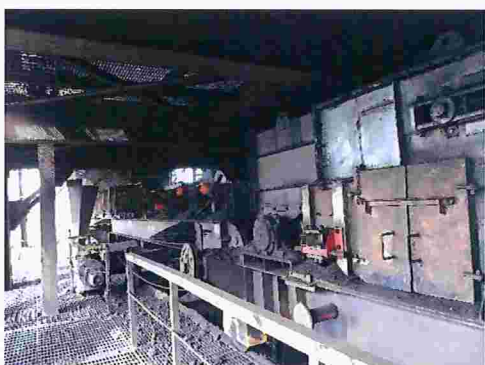
Figura 9 – Acúmulo de materiais na estrutura dos chutes de carvão
