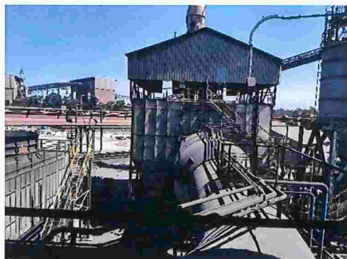
Figura 137 – Filtro de mangas do despoeiramento
