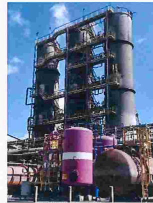
Figura 76 – Detalhe dos 2 lavadores spray com água para retirada da amônia e 1 com diesel para retirada de naftaleno
