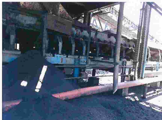
Figura 62 – Acúmulo de material no ponto de transferência entre correias
