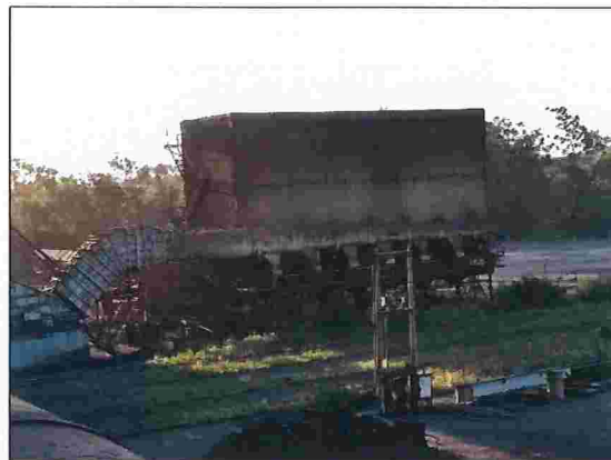
Figura 117 – Filtro de mangas de despoiramento sem lanternim e sem chaminé.
