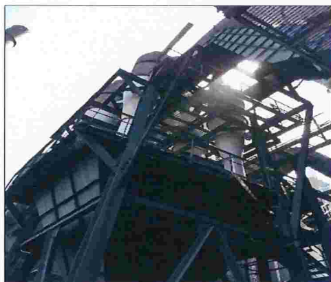
Figura 86 – Ciclones + Filtro de mangas da operação de descarga (descida do carro)
