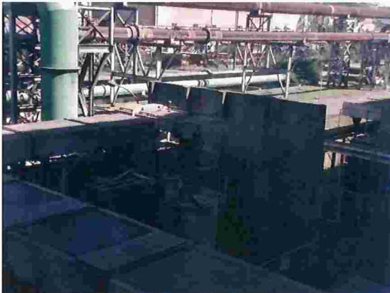
Figura 51 – Tubulação de água do mar para resfriamento do vapor com retorno para a caldeira
