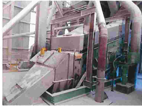
Figura 107 - Pó depositado nos equipamentos (peneira), estruturas e piso
