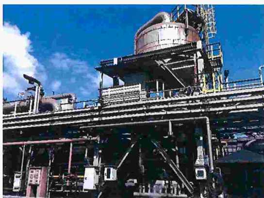
Figura 77 – Detalhe do processo Claus
