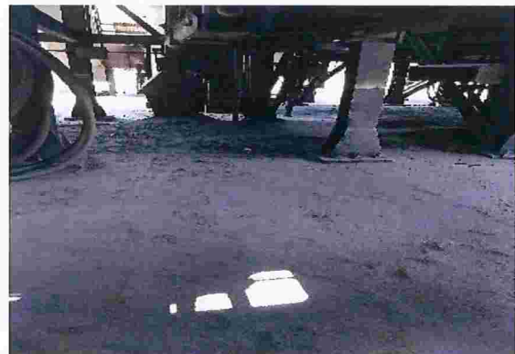
Figura 83 – Detalhe do interior da baghouse com acúmulo de pó
