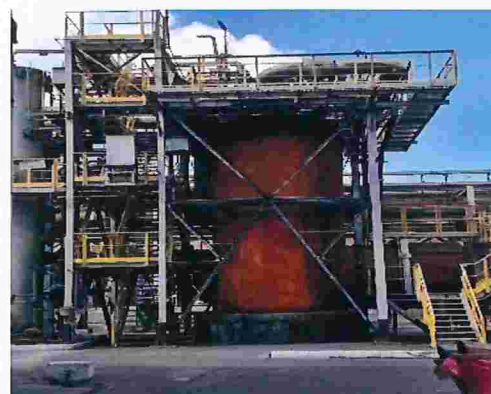
Figura 78 – Pós-queimador para tratamento de gases com processo Claus fora de operação
