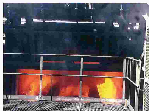
Figura 95 – Detalhe das emissões fugitivas durante as operações
