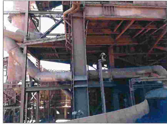
Figura 163 – Duto do sistema de captação da emissão dos carros de sinter
