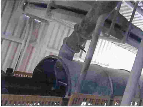
Figura 106 – Pontos de captação deficientes
