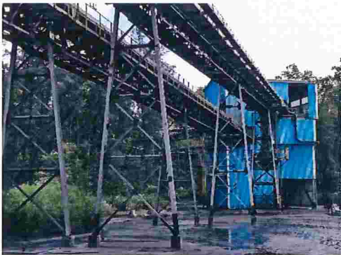
Figura 17 – Correias transportadoras de coque (externa/direita) e de carvão (interna/esquerda) sem bandejamento e sem contenção lateral
