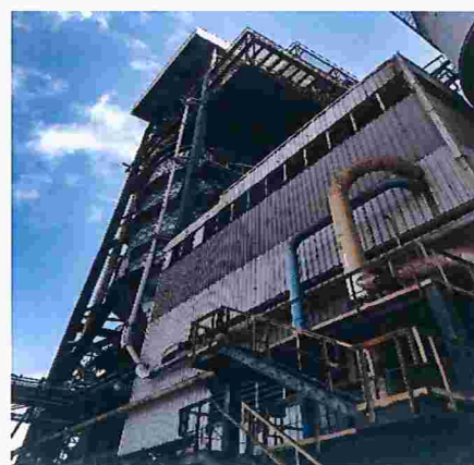
Figura 55 – Detalhe do silo da unidade de moagem de PCI
