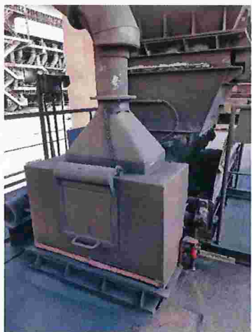
Figuras 90 – Descarga do silo em correia dosadora com captação
