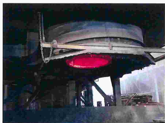
Figura 68 – Detalhe do ponto de captação do processo IRUT de refino secundário
