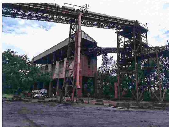
Figura 77 – Detalhe das correias transportadoras, chute e silos de materiais.
