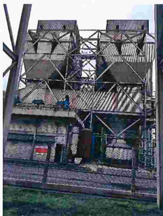
Figura 38 – Tratamento de gases (FGD)
