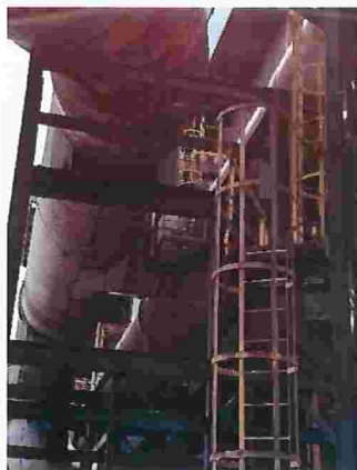
Figura 50 – Ponto de manobra entre dutos para desvio de lançamento dos gases (damper)
