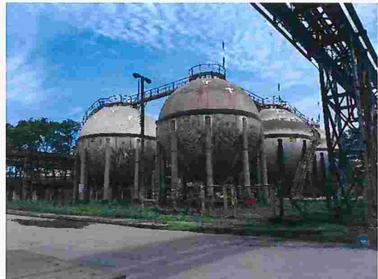
Figura 58 – Área de tanques de gases oxigênio e nitrogênio
