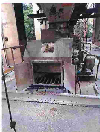
Figura 78 – Detalhe da área de silos (blend stockers) com material depositado no piso
