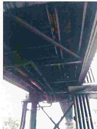
Figura 7 – Detalhe inferior da correia transportadora de carvão
