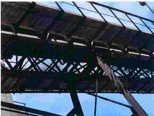
Figura 45 – detalhe da correia transportadora de escória granulada sem contenção
