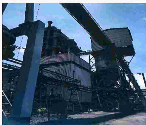
Figura 54 – Correias transportadoras e chute de carvão para moagem
