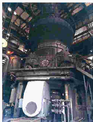
Figura 52 – Detalhe do moinho de PCI
