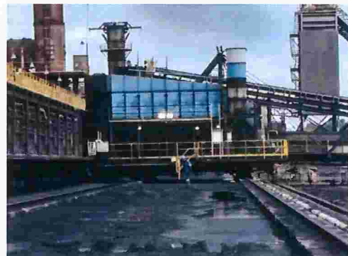
Figura 23 – Detalhe da máquina enfornadora provida de filtro de mangas (damper fechado)
