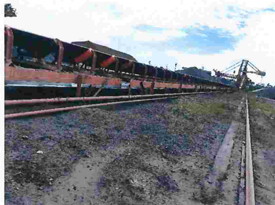
Figura 75 – Corriente transportadora do pátio de materiais
