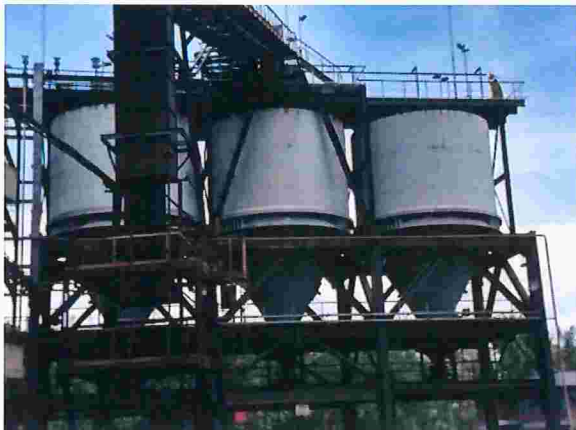
Figura 47 – Silo de escória para expedição por caminhões
