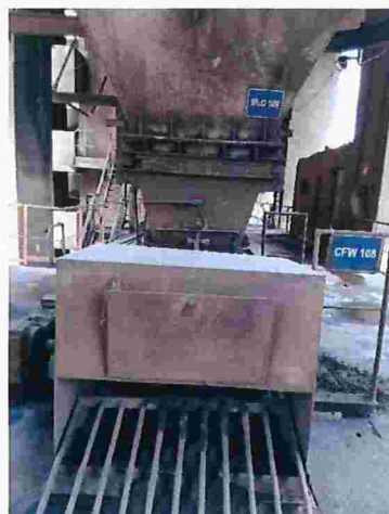
Figura 91 – Descarga do silo em correia dosadora sem captação
