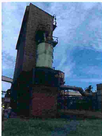
Figura 61 – Detalhe do outro sistema de despoeiramento da descarga do ferro gusa
