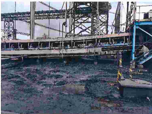
Figura 30 – Detalhe de material depositado no solo das correias transportadoras
