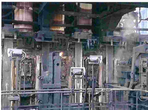
Figura 13 – Emissão fugitiva das portas dos fornos da coqueria
