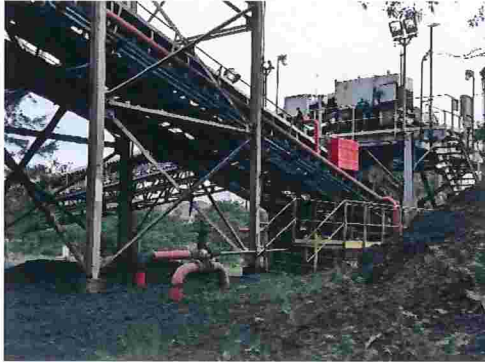
Figura 28 – Detalhe de material depositado no solo das correias transportadoras de carvão sem bandejamento e proteção lateral
