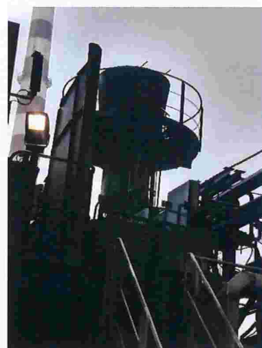
Figura 18 – Saída de emergência dos gases da coqueria
