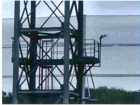
Figura 25 – Detalhe do bico aspersor de água do pátio de carvão
