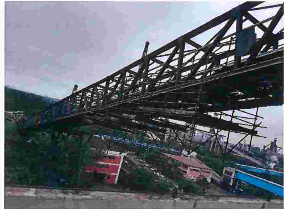
Figura 3 – Correia transportadora de carvão com bandejamento precário sobre via
